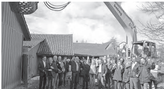
Um das Bauprojekt zu realisieren, müssen zuerst alle Schöplie abgebrochen werden. Dieser historische Moment wurde tüchtig gefeiert mit künftigen Wohnungseigentümern, einstigen Landbesitzern, Handwerkern und Unternehmern. Ganz rechts: Daniel Seger und Beat Seger, Geschäftsleitung der Construco.
